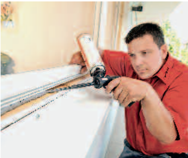
Schritt 5: Jetzt schäumen Sie den Zwischenraum vom alten und neuen Fensterrahmen mit FCKW-freiem Polyurethanschaum aus: Dieser Schritt verbessert die Wärmedämmung.
